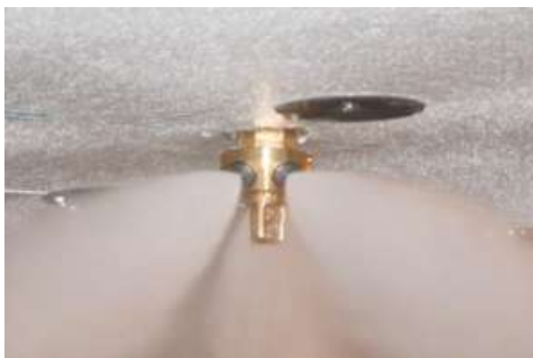
Рис. 84. Стационарные автоматические установки водяного пожаротушения
